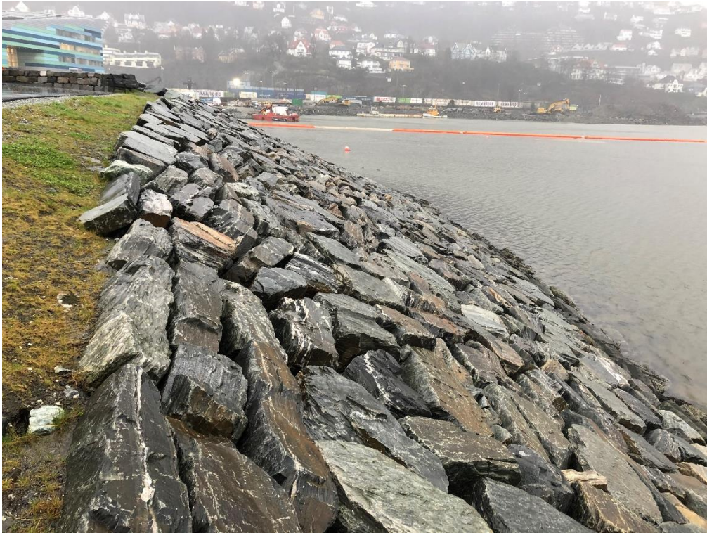
Bilde 1: Erosjonssikring og forbygning - må det gjøres sånn?
