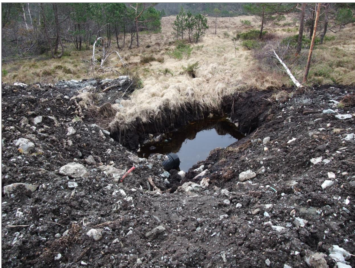
Figur 8. Fanafjellet i 2018. Regionalt viktig våtmarksområde er drenert og fylt med masser fulle av rivningsavfall. Søknad på denne skogsbilveien ble avslått i 2018, men veien ble bygget likevel. Veifyllingen har dermed ødelagt våtmarksområdet, i tillegg til den historiske kirkevegen mellom Fana og Nordvik (sannsynligvis av middelaldersk opprinnelse). Landbruksetaten lovliggjorde tiltaket i mai 2022, men daværende byråd Ingrid Nergaard Fjeldstad slo i juni 2023 fast at veien er ulovlig bygget. Foto: Synnøve Spangelo.
