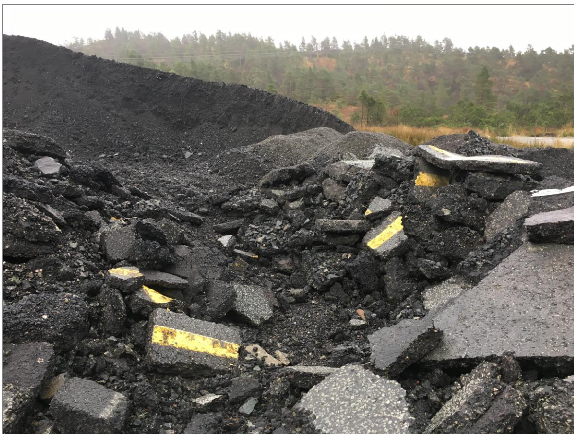
Figur 6. Dumping av asfalt i myr, i forbindelse med bygging av skogsbilvei på Fanafjellet i 2017. Byggingen av skogsbilveien er under etterforskning av Vest politidistrikt. Foto: Finn Bøe.
