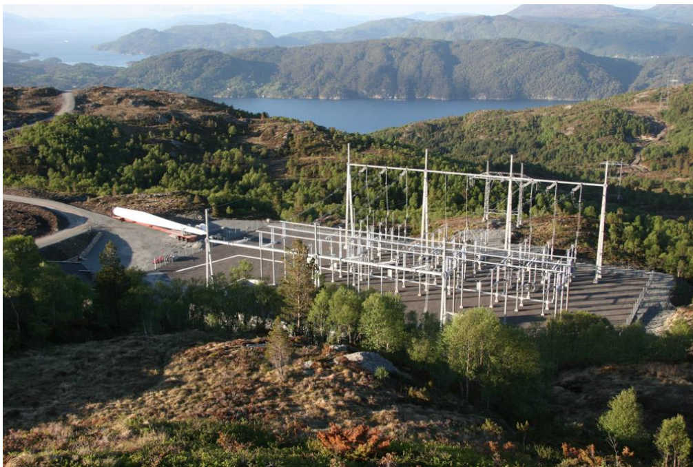
Trafostasjon på Mitdfjellet, Fitjar – turbinvingen som ligger ved siden av er 44 m lang Foto: Sveinulf Vågene
