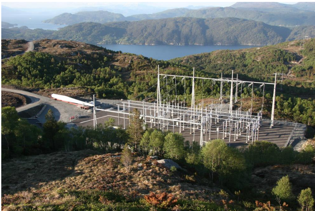
Trafostasjon på Mitdfjellet, Fitjar – turbinvingen som ligger ved siden av er 44 m lang Foto: Sveinulf Vågene
