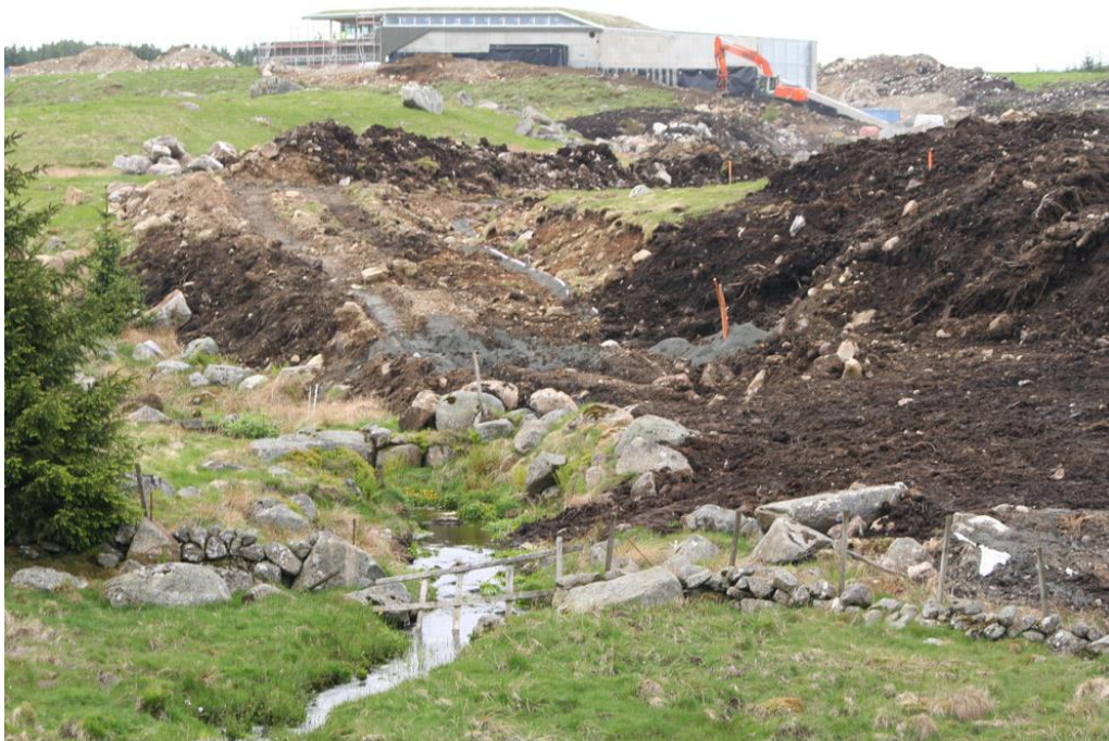
Inngrep på Høg-Jæren som viser avrenning til bekk – bekkene renner ut i Håelva der det fortsatt fantes elvemussling. I bakgrunnen sees driftsbygningen og en gravemaskin Foto: FNF Rogaland
