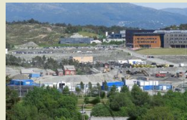
Slik ser det ut langs deler av Flyplassvegen i dag. En enorm anleggsaktivitet, men lite bygging. Mangelen på næringsarealer i Bergen er avblåst, mener innsenderne. Posten-hogsten ses oppe til venstre. FOTO: GUNVAR MIKKELSEN/FNF HORDALAND.
