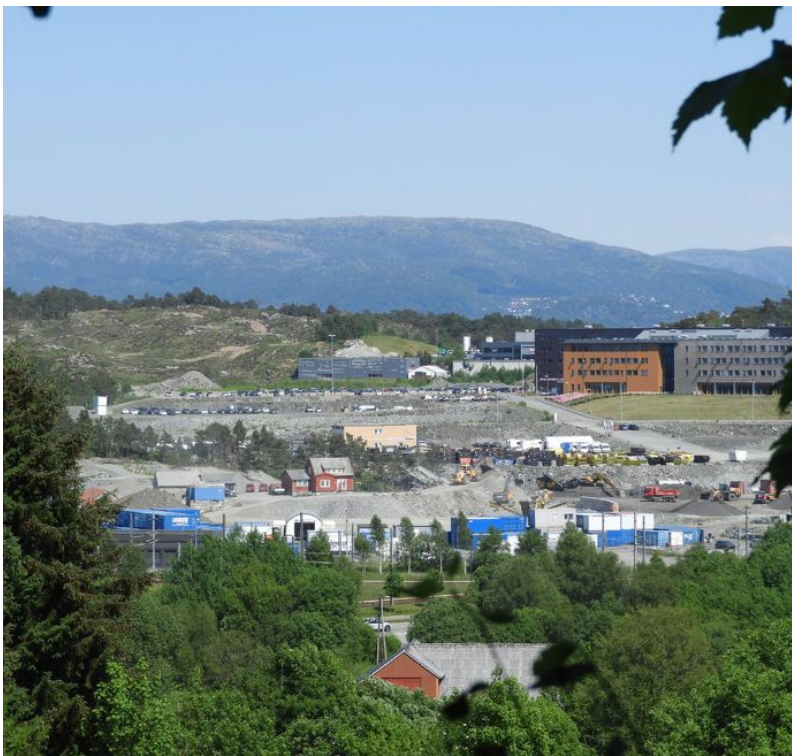
FLESLANDSMARKA: Slik ser det ut langs deler av Flyplassvegen i dag. En voldsom anleggsaktivitet, både på sør- og nordsiden av veien. Postenhogsten (hogget mars 2023) ses oppe til venstre. FOTO: GUNVAR MIKKELSEN, FNF HORDALAND
